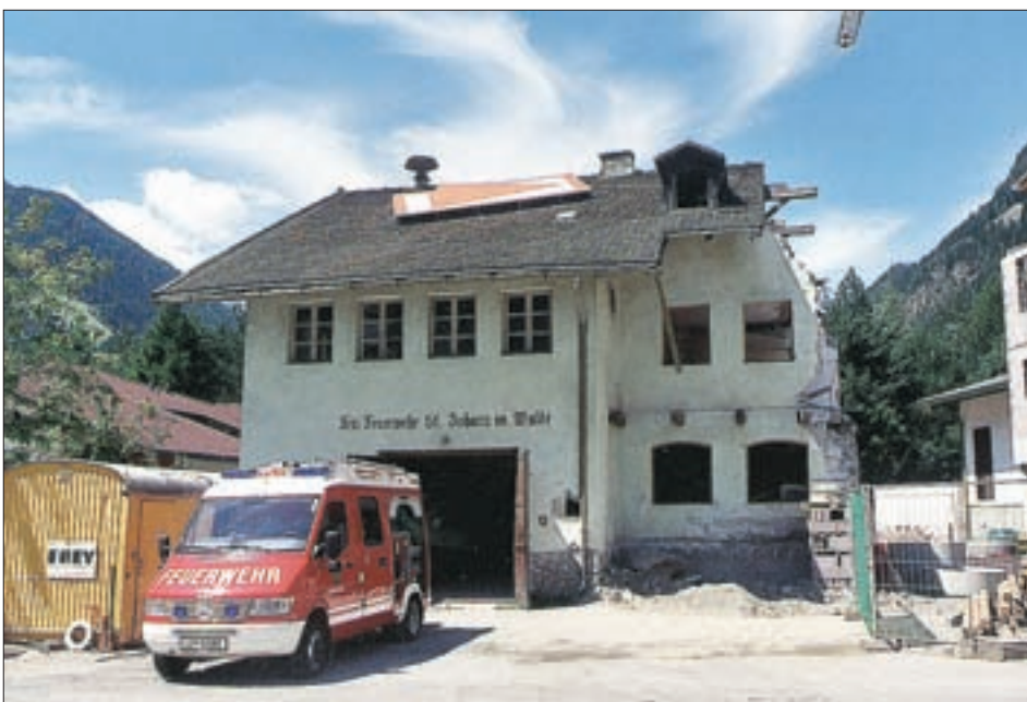
Altes Feuerwehrhaus in St. Johann i. W., beim Abriss, rechts vom Garagentor die kleine Nisthöhle (brauner Fleck).
